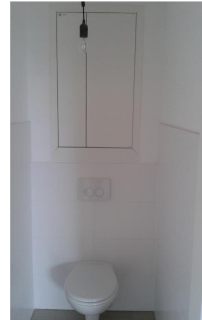
Fertig eingebautes Lüftungsgerät mit WC-Ausschubmodul
